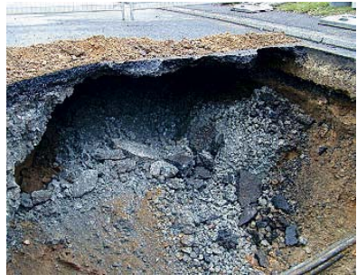
Hohlraum unter der Fahrbahn
